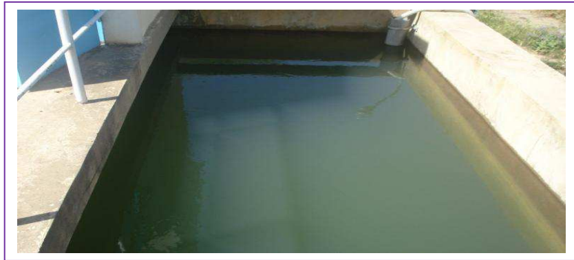
Figure 8 : Bassin de la coagulation.
