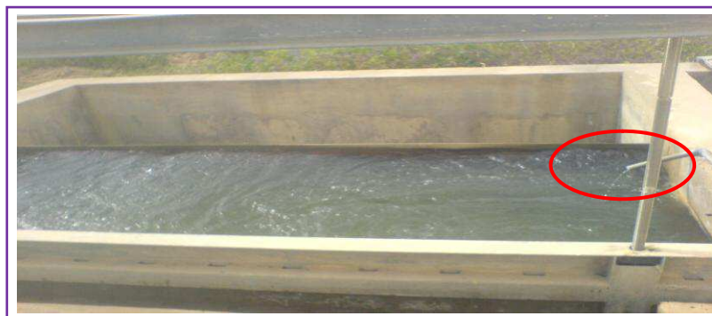
Figure 7 : La pré-chloration dans le premier bassin de mélange.
