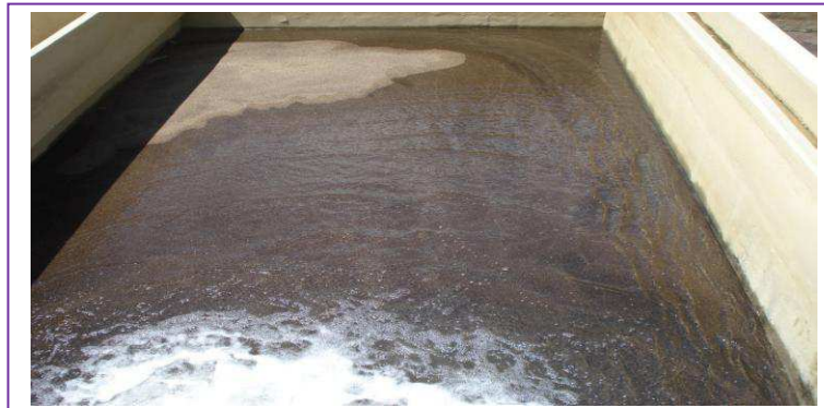
Figure 11 : Bassin d'un filtre à sable
