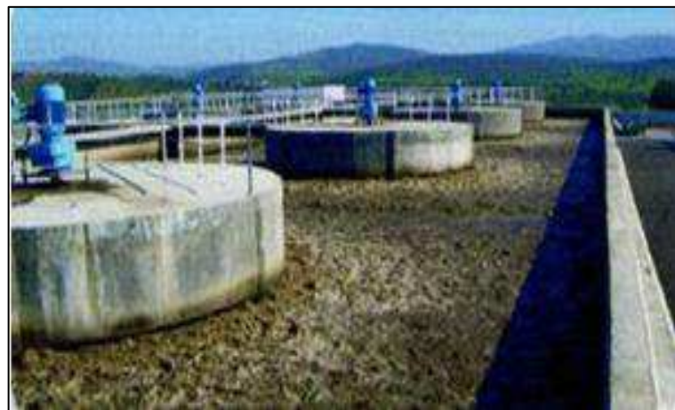
Figure 07 : Bassin d'aération (ONA, 2012).
